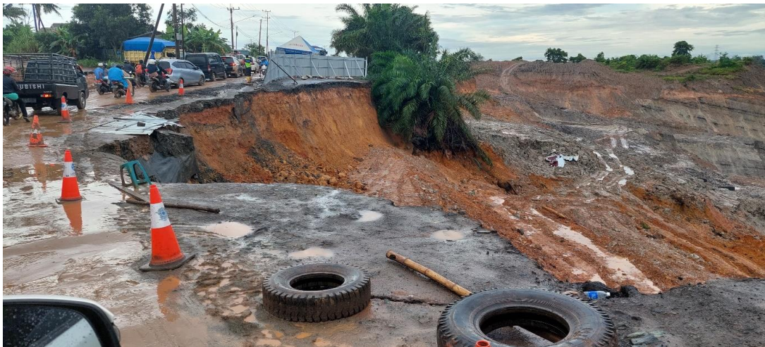
Gambar 1. Jalan Nasional Longsor KM 171 Satui Karena Aktivitas Tambang
